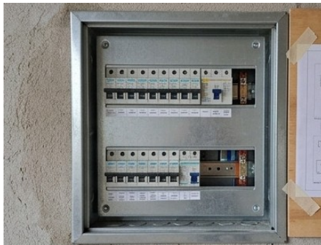
Foto do quadro ou painel elétrico
