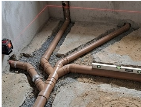
Foto de tubulações de esgoto e caimento
