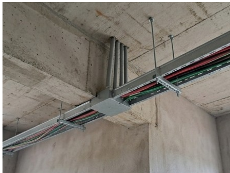
Foto de eletrocalhas e caminhos de cabos
