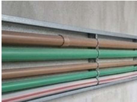
Foto de tubulações de água - vista geral
