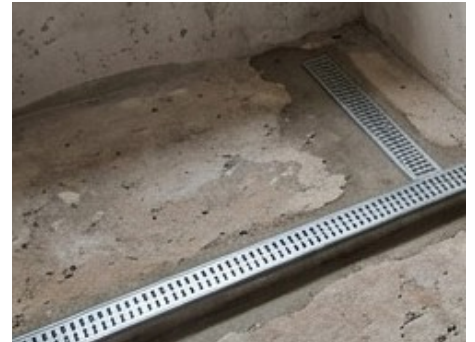
Foto de aparelhos sanitários e ralos
